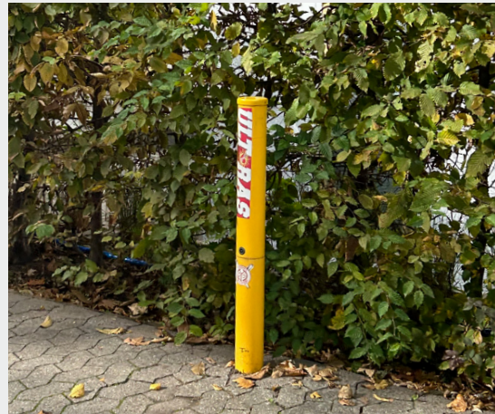
KKS Messstellenposten Gas-HD
