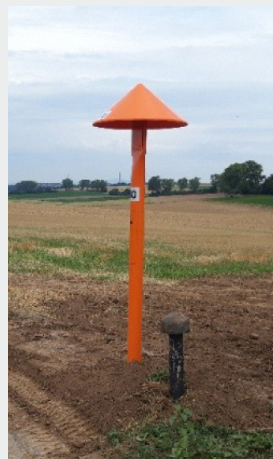
KKS Messstellenposten Wasser
