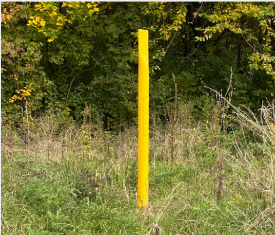
KKS Messstellenposten Gas-HD
