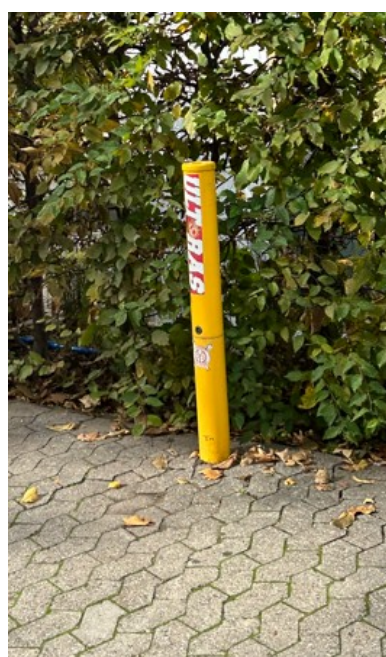
Abbildung 2: KKS Messtellenpfosten Gas-HD
