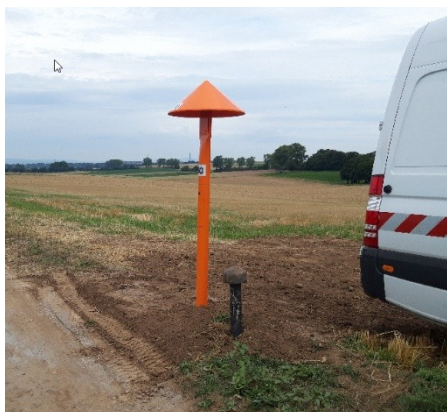
Abbildung 12: KKS Messstellenposten Wasser
