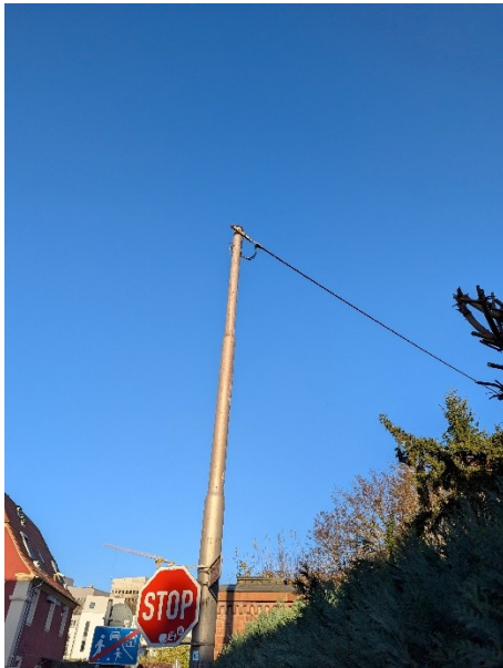
Abbildung 22: Freileitung Niederspannung Hochspannung
